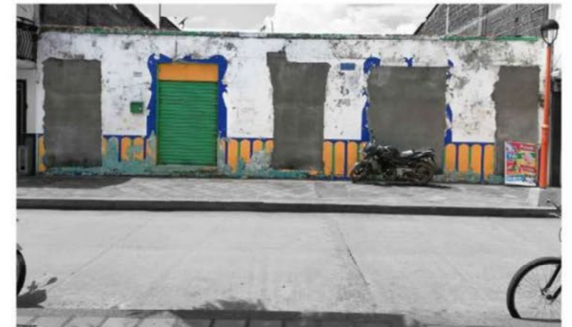
Vivienda en deterioro
