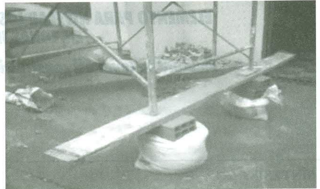
Imagen 1: Improvisación de montaje para nivelar andamios
