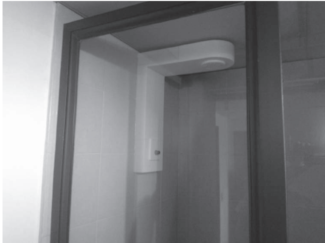
Fig. 7. Proyecto final instalado
